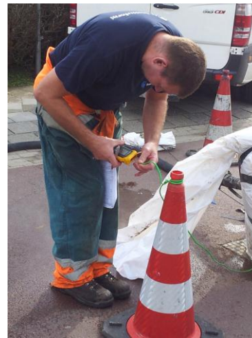
Bild 3.1: Temperaturmessung mittels Thermoelement im Schachtbereich
